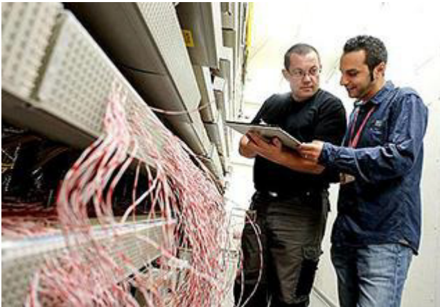
In der Vermittlungsstelle Köln bereiten Thomas Behle und Francesco Capici eine nächtliche Umschaltung vor.
